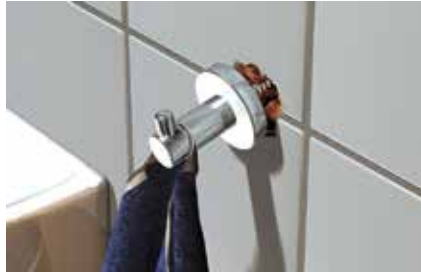
Reparatur ausgerissener Handtuchhalter
