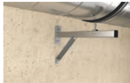
Lüftungsrohrbefestigung an der Wand
