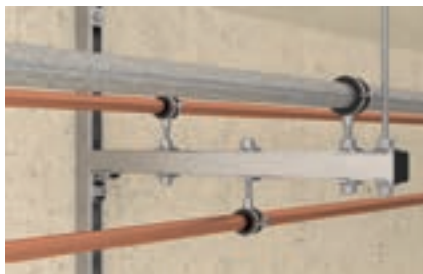
Konsolenkonstruktion mit Schienen
