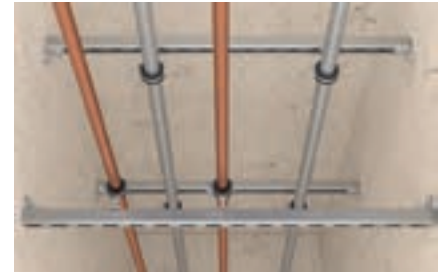
Rohrbefestigung im Flurbereich
